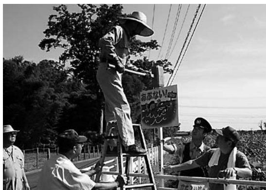
市内3カ所に水難事故防止看板を設置
